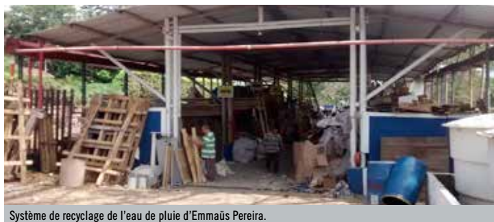
Système de recyclage de l'eau de pluie d'Emmaüs Pereira.
